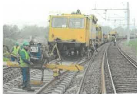
Longs Rails soudés sur traverses béton
